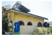
Techo del CECAM con Sistema de Captación de Agua Pluvial (SCPAP) y energía alternativa como el calentador solar
